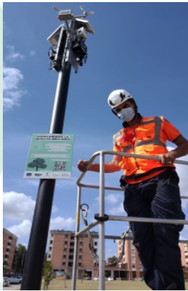
Centralina rilevazione inquinanti
